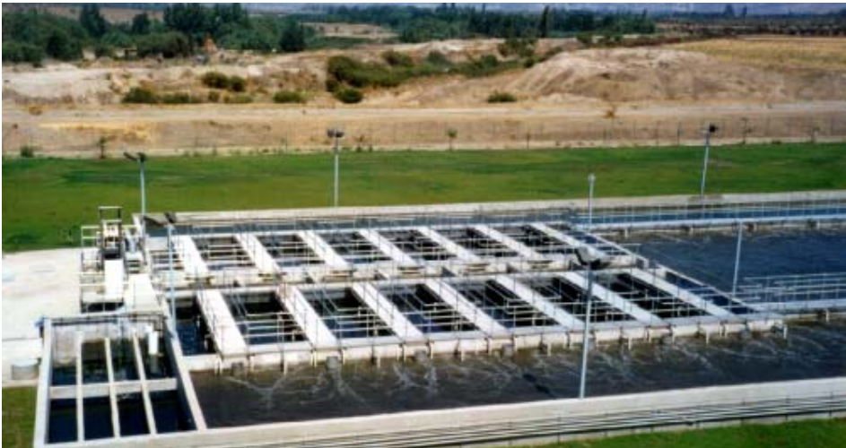
Le clarificateur ClarAtor est installé dans basins de béton. Le design consiste en construction avec de murs communs pour réduire les coûts.
